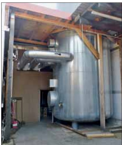
Zentrales Element ist der Pufferspeicher.
