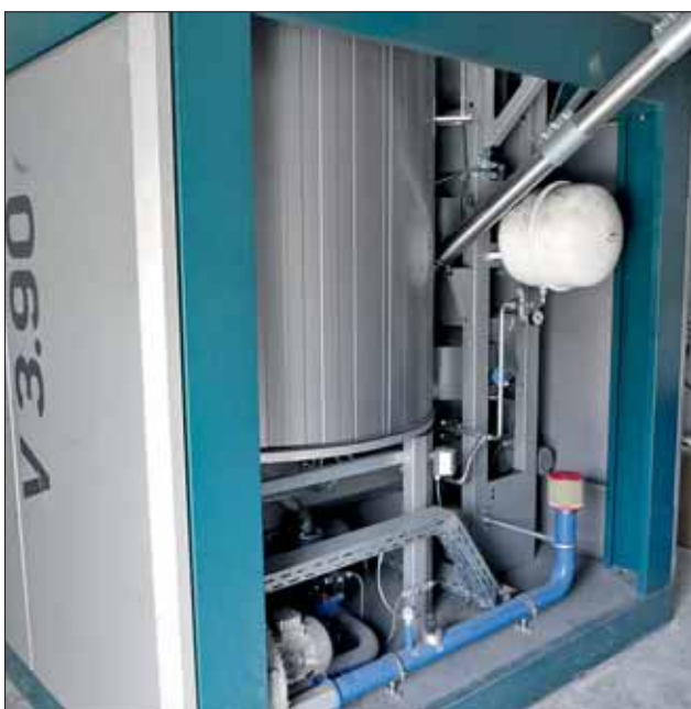
Die Grundlast der Wärmeversorgung tragen die Vergaseranlage auf Basis von Pellets ...
