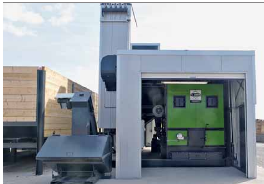
Nachdem die Betonplatte vorbereitet war, dauerte die Aufstellung (von rechts) des Containers mit Kessel, des Filters, der Entaschung und des Bunkers mit Förder-technik nur wenige Stunden.
