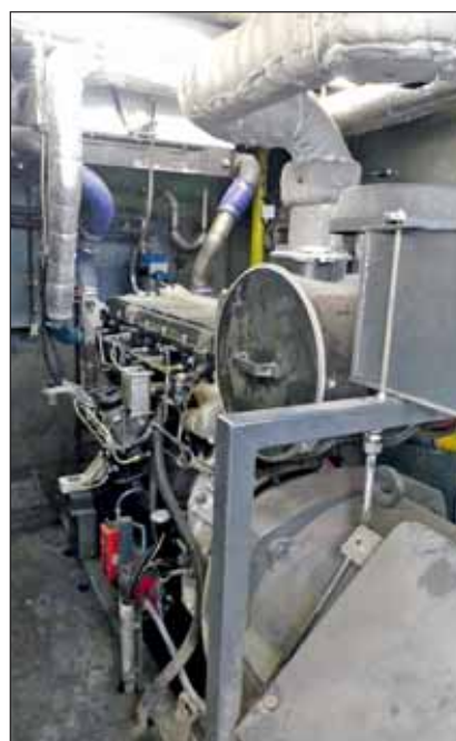
... und der Motor des BHKW.
